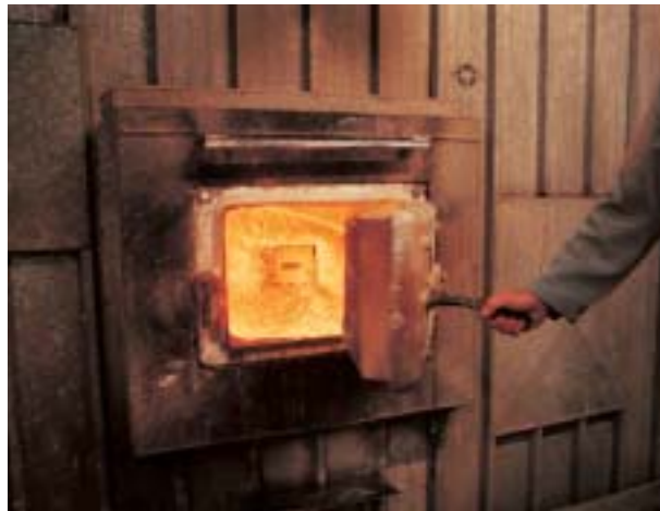
Die Kraft-Wärme-Anlage unserer Kaffee-fabrik in Mainz, in der Kaffeesatz als Brennstoff verwendet wird
